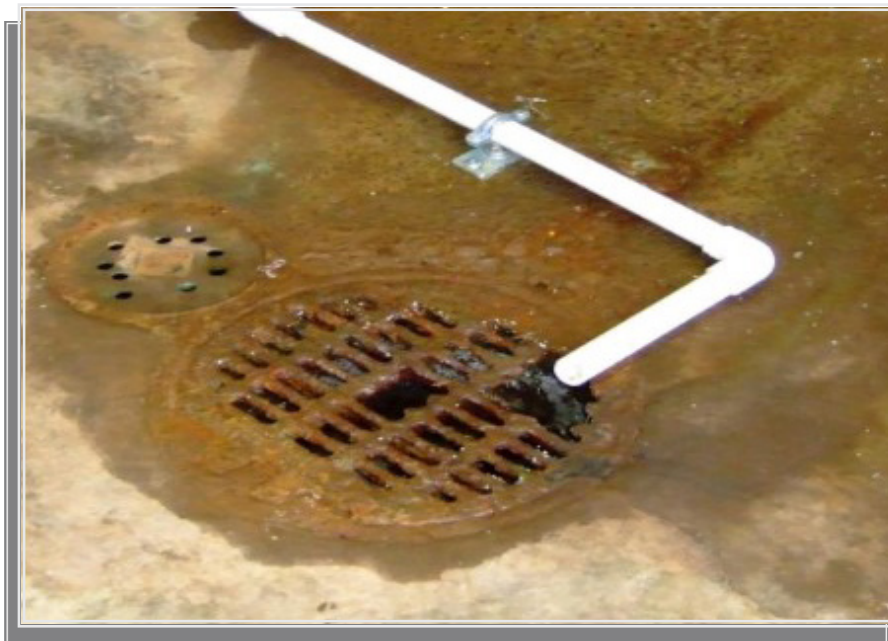
▲ شکل ۲-۳ آسیب ایجاد شده ناشی از کندانس حاصل از محصولات احتراق
